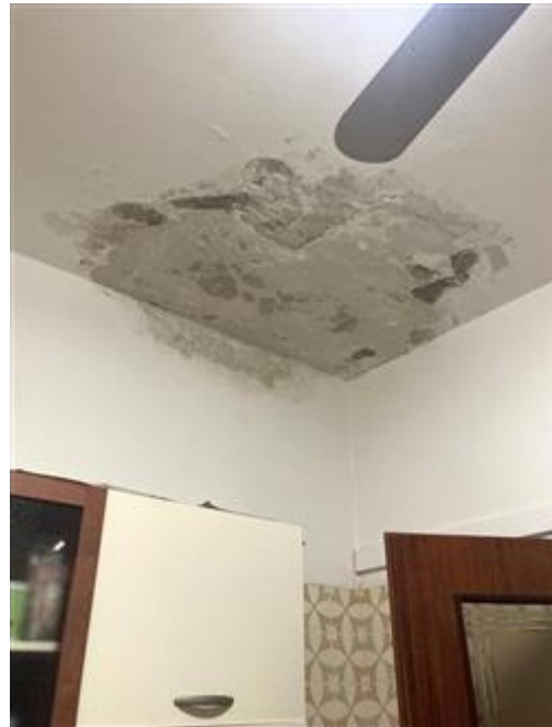
foto n. 10 - umidità presente nel vano cucina
