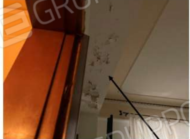
Fig. n. 15 Particolari delle macchie di umidità
