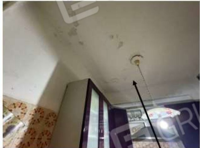
Fig. n. 17 Particolari delle macchie di umidità
