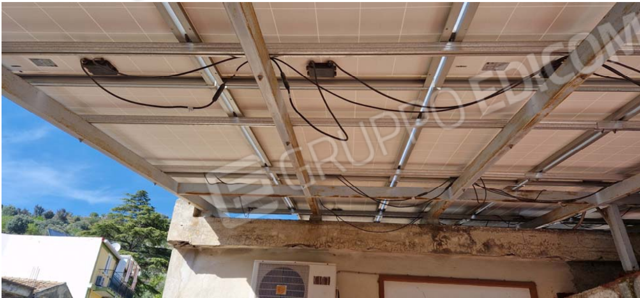
Foto 24: Impianto fotovoltaico realizzato sulla terrazza a livello.
