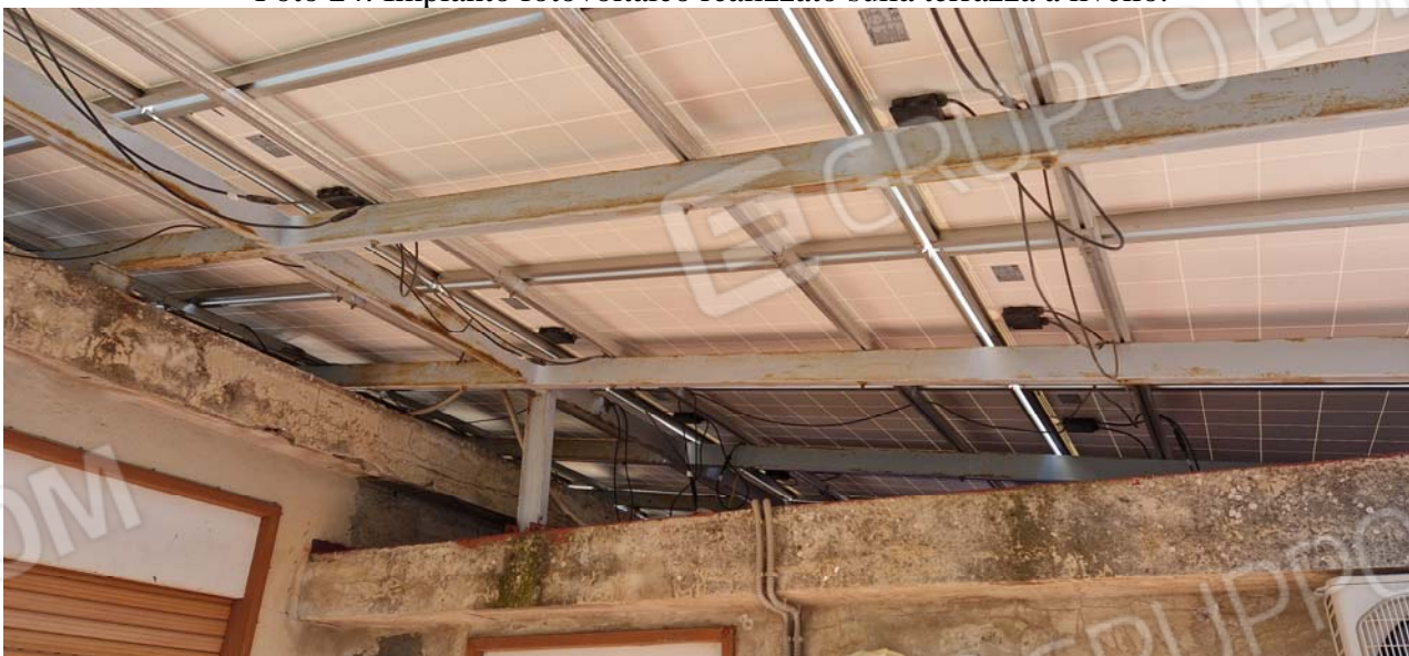
Foto 25: Impianto fotovoltaico realizzato sulla terrazza a livello.
