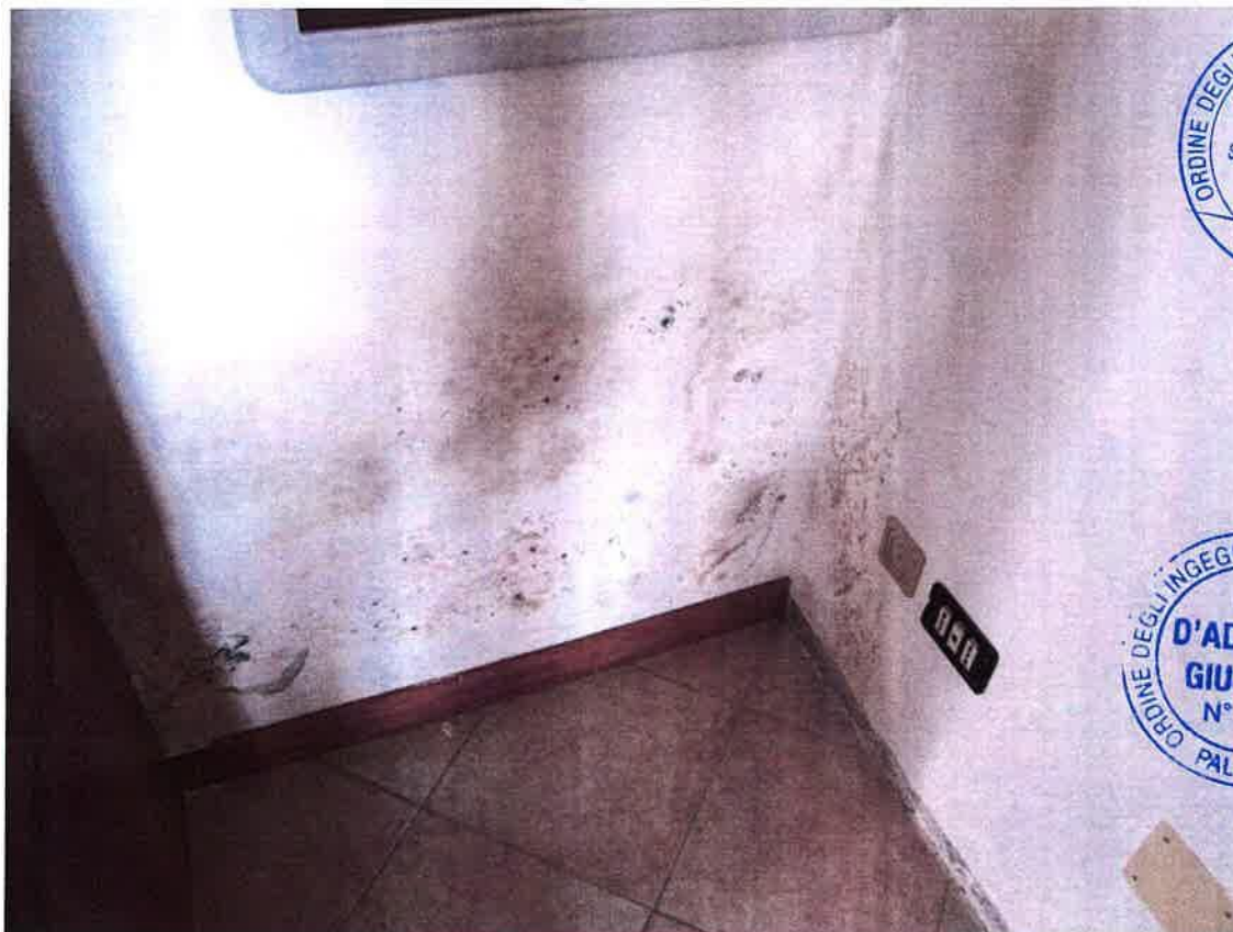
Foto 28: la presenza di muffe rilevate nella parte bassa delle pareti del "locale deposito", al terzo piano
