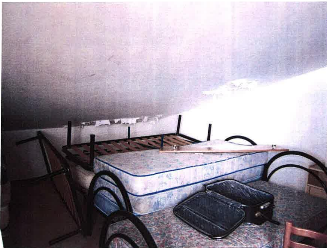
Foto 29: le manifestazioni di infiltrazioni di acqua piovana nell'intradosso del tetto del "locale deposito", al terzo piano
