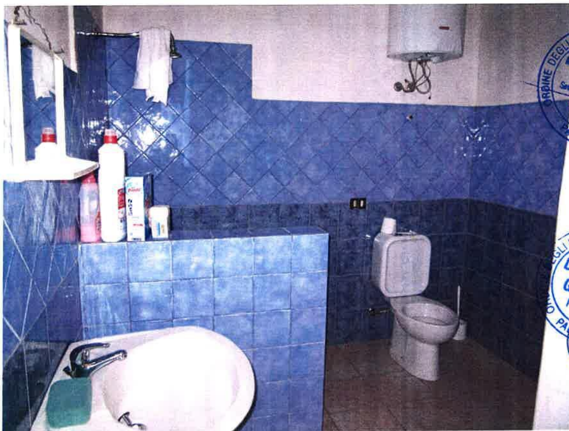
Foto 22: il servizio w.c. doccia ricavato subito a sinistra dello sbarco della scala, non previsto progettualmente e non rappresentato catastalmente
