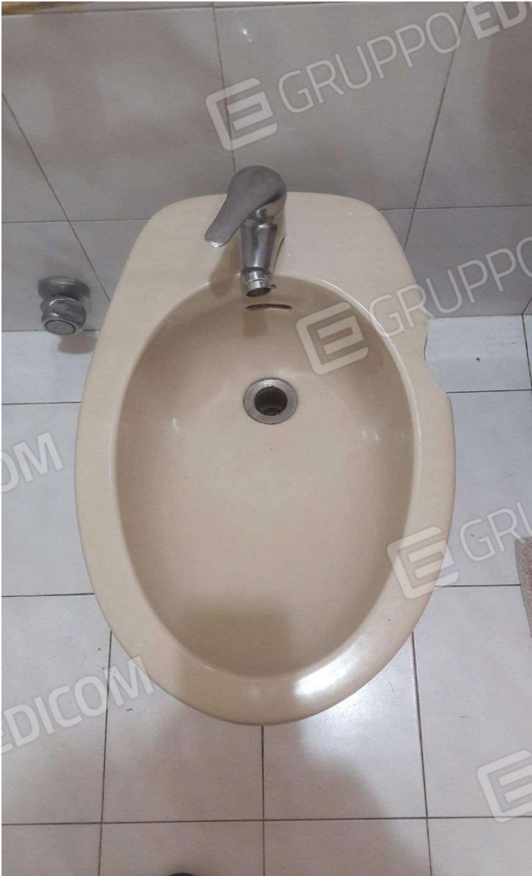
FOTO N.24 BIDET DANNEGGIATO E RUBINETTERIA
