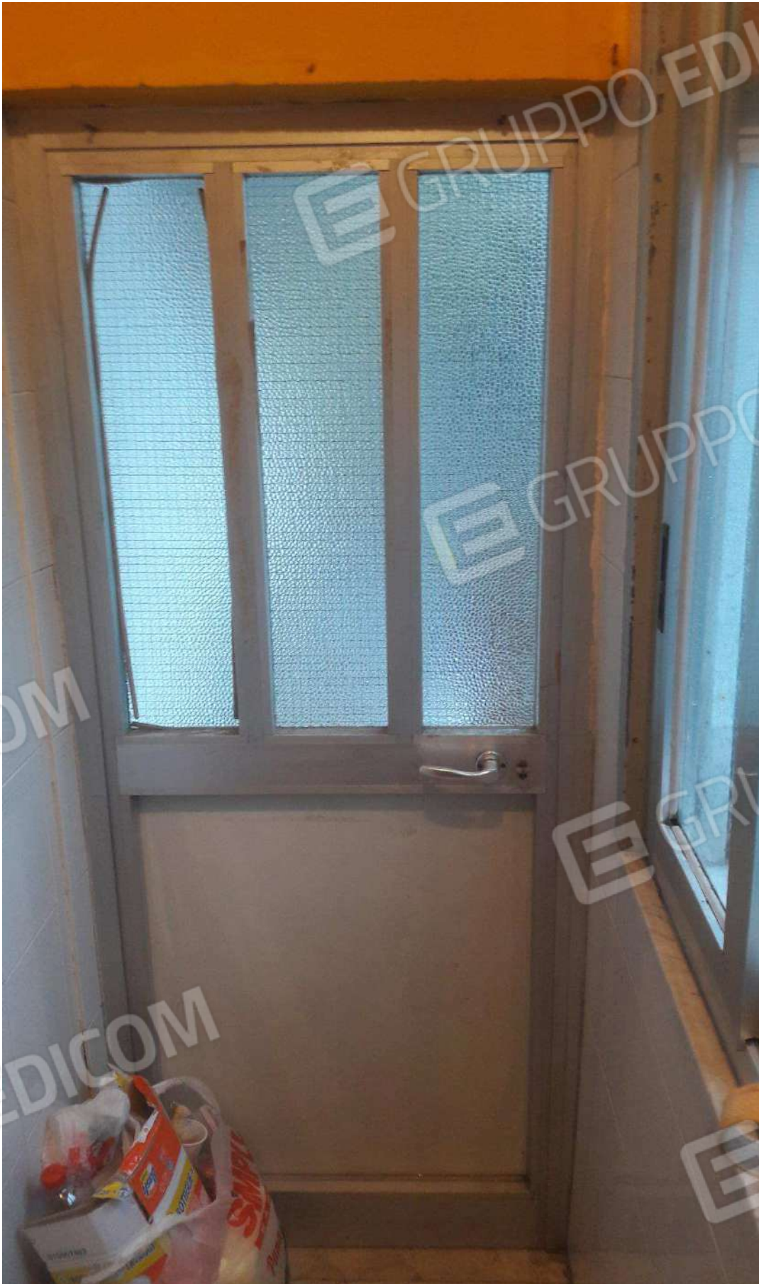
FOTO N.16 INFISSO ESTERNO TRA IL VECCHIO ED IL NUOVO BALCONE
