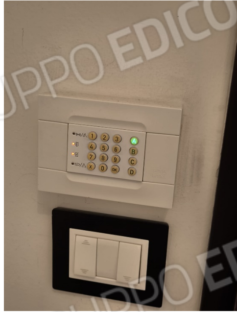
SISTEMA ALLARME ANTI-INTRUSIONE
