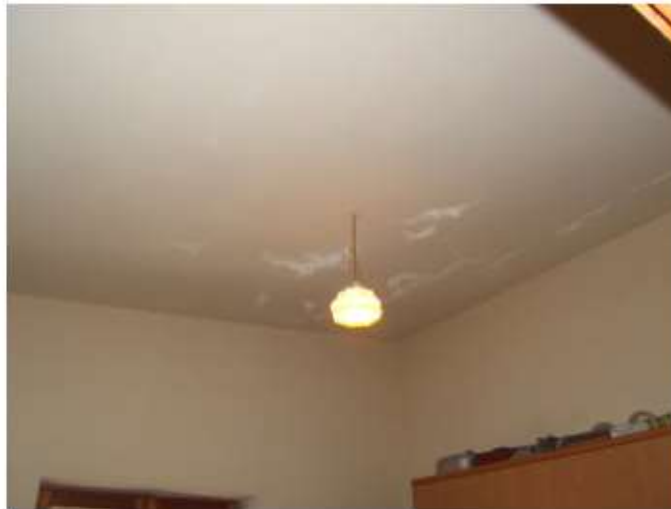
Foto n. 14: Lotto 2 – Tracce d'umido e lesioni nella camera con affaccio su via Napoli
