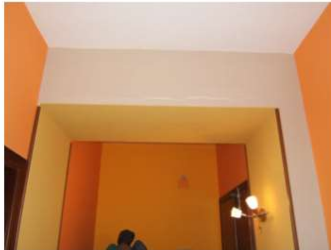
Foto n. 23: Lotto 3 – Lesioni in corrispondenza del giunto
