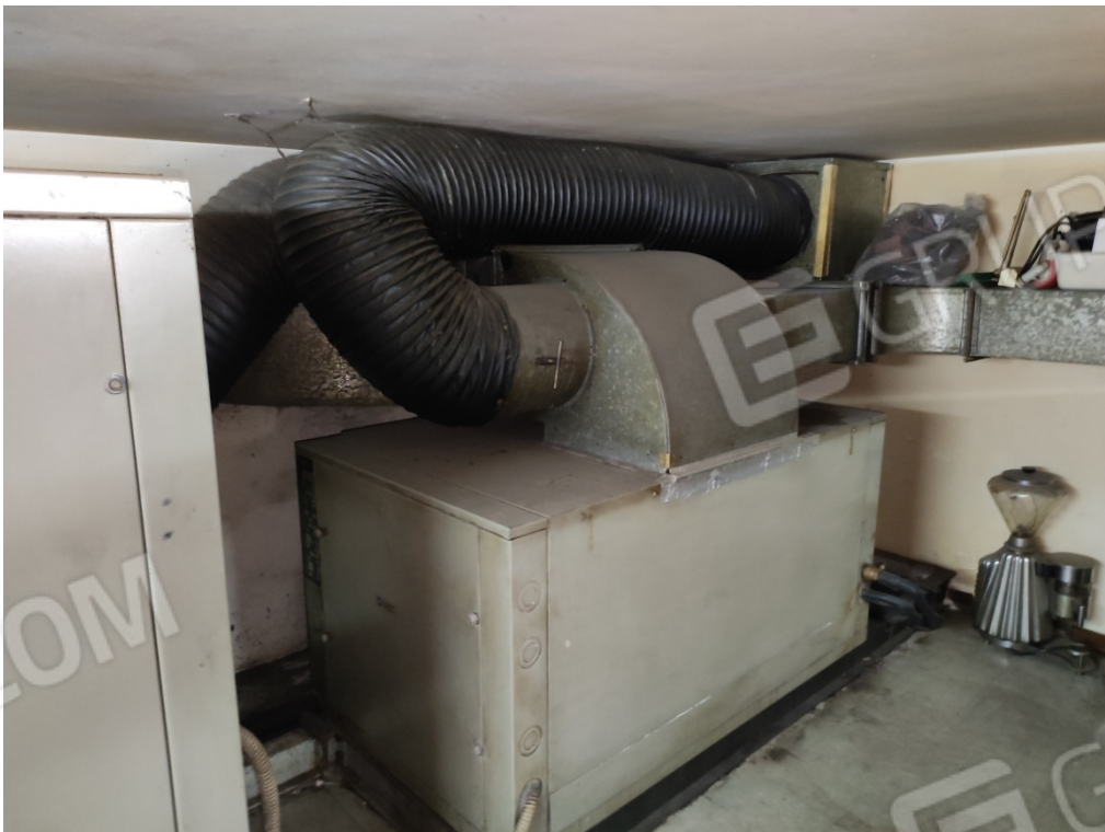
Foto 37 e 38 – Veduta dello scambiatore e dell'aspiratore del locale tecnico.
