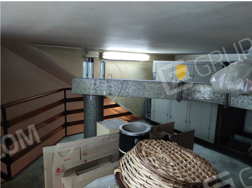
Foto 39 e 40 – Veduta della canalizzazione del locale tecnico.
