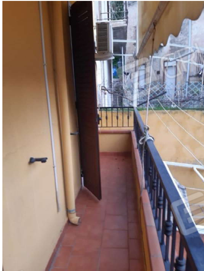
FOTO 16 – BALCONE – PIANO PRIMO
