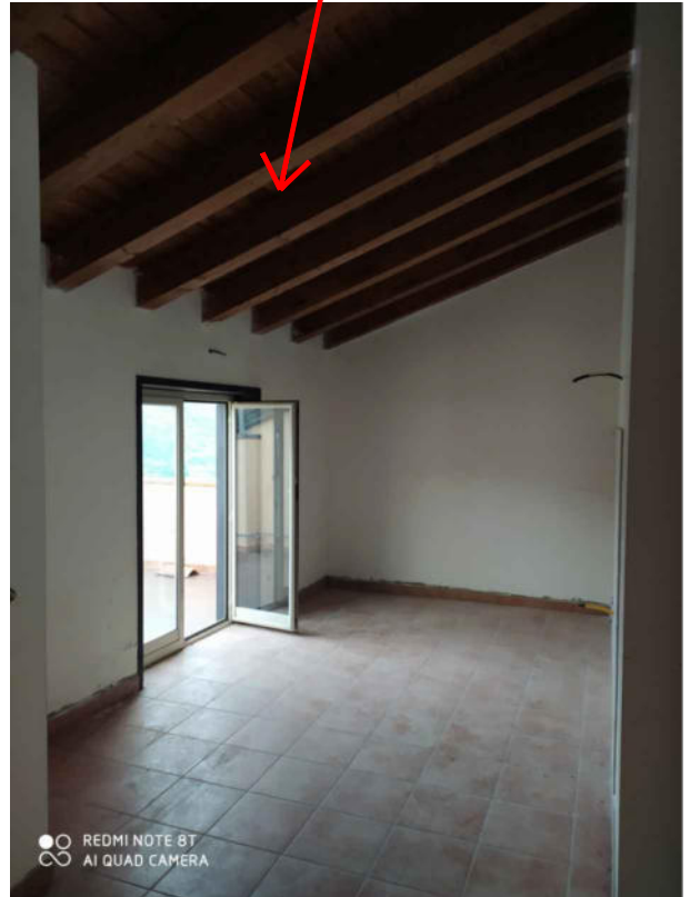
Foto n° 58 – Sub. 36, Locale di sgombero
