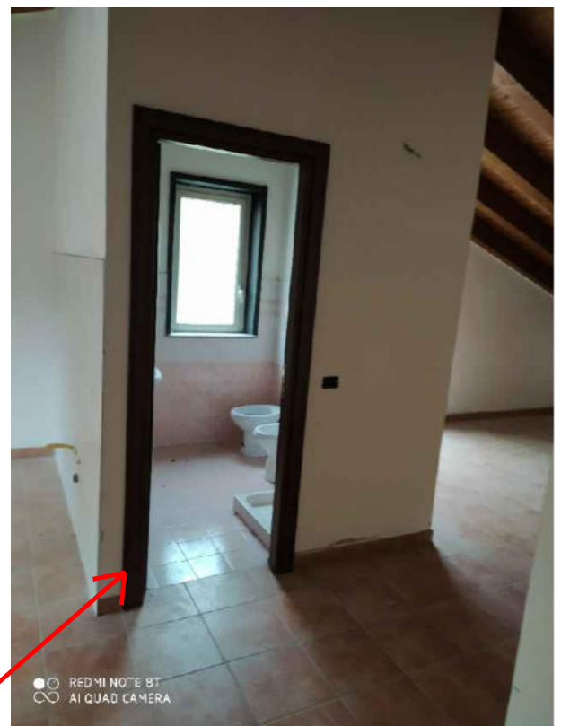
Foto n° 53 – Sub. 19, Locale di sgombero
