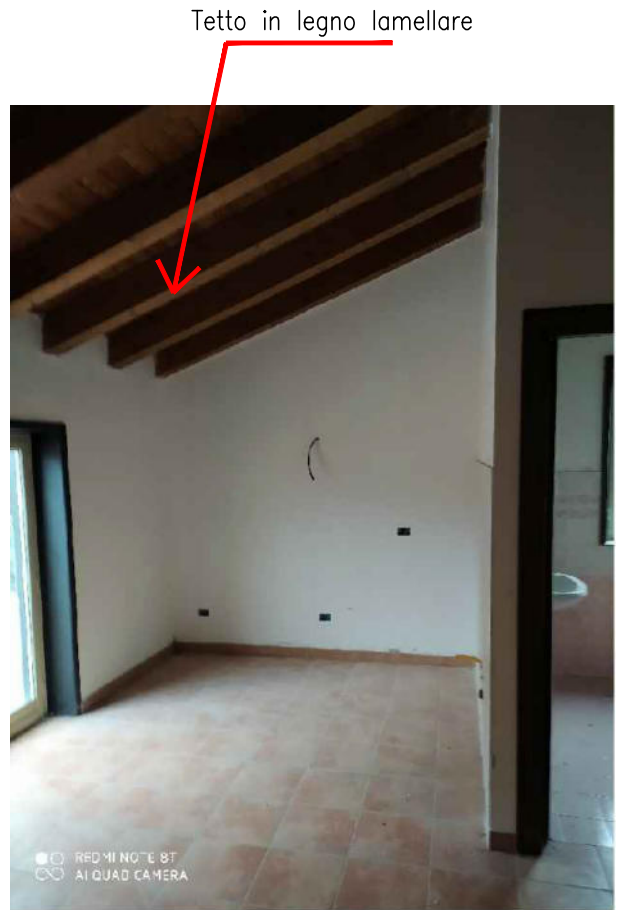
Foto n° 51 – Sub. 19, Locale di sgombero
