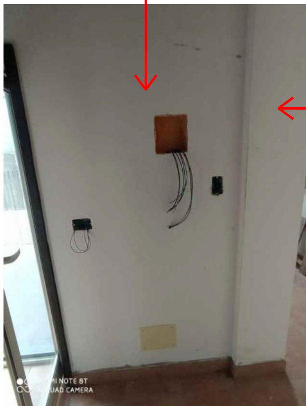
Foto n° 15 – Sub. 15, Impianto elettrico
