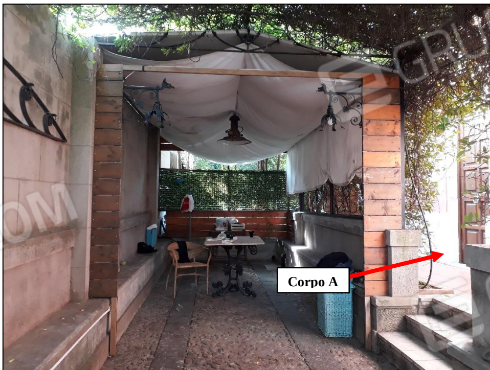
FOTO 34: tettoia abusiva ingresso corte.
