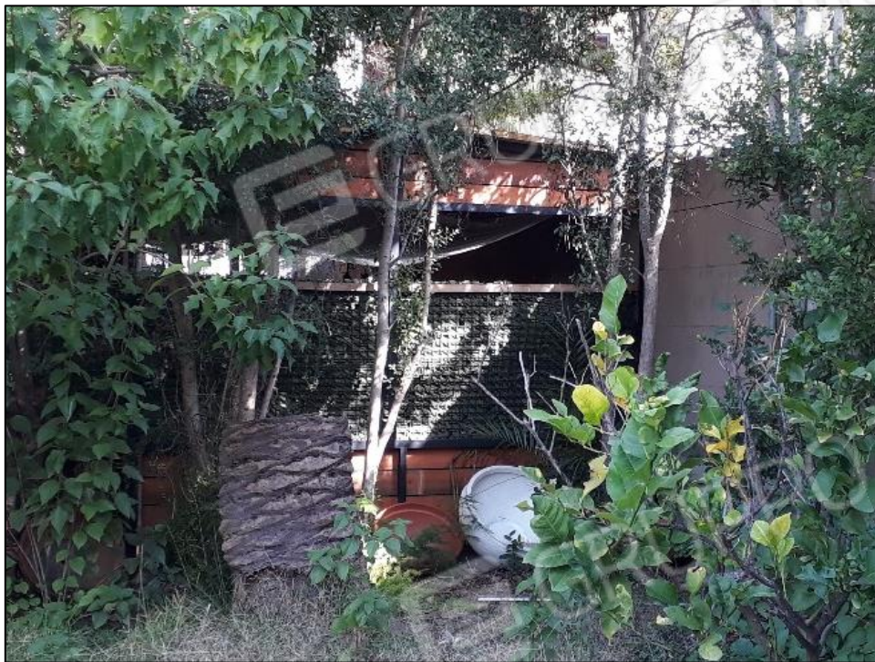
FOTO 35: prospetto sud tettoia abusiva.
