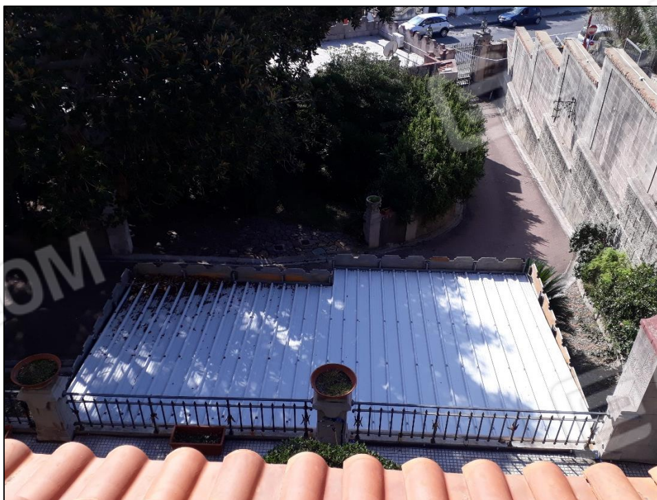
FOTO 28: veduta copertura tettoia abusiva.
