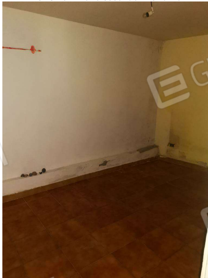
FOTO 14 – tracce di umidità
