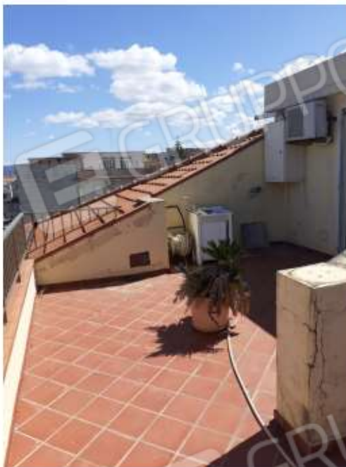
Foto nr. 11: particolare terrazzo da cui si evince la necessità di manutenzione straordinaria
