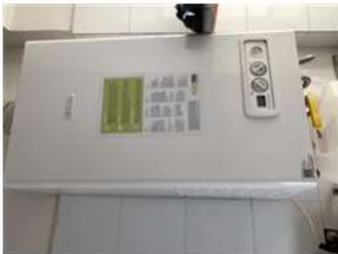
caldaia a servizio dell'immobile
