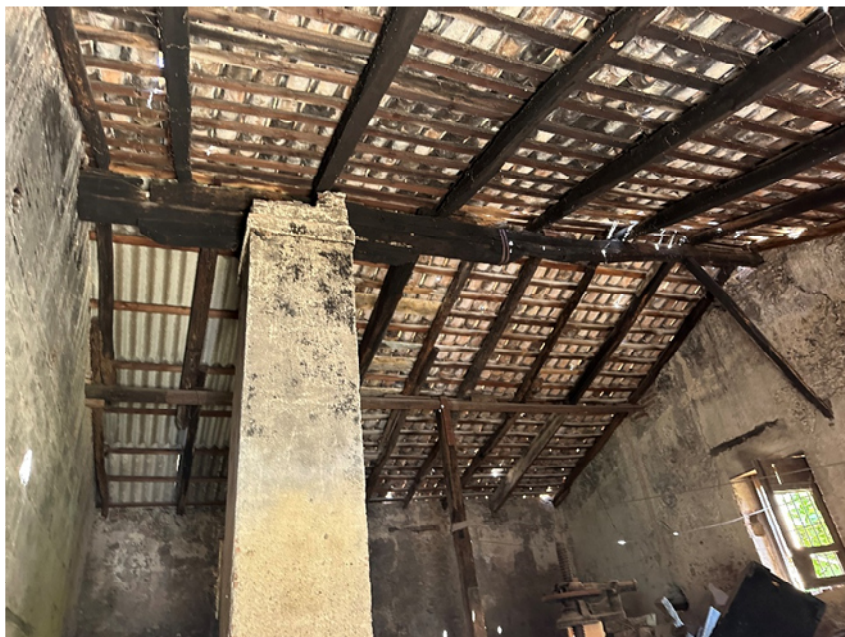
Foto nr. 11 : particolare della part. sub. 274 – copertura da ripristinare, in quanto fatiscente
