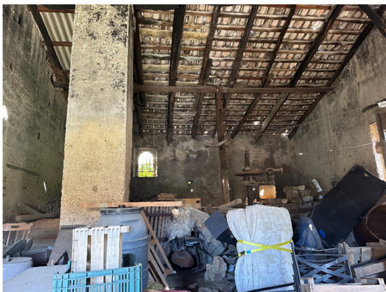
Foto nr. 12 :: particolare della part. sub. 274 – copertura da ripristinare, in quanto fatiscente -
