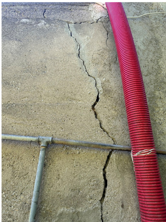
Foto nr. 20 : quadro fessurativo preoccupante, lato nord-est – piano terra -
