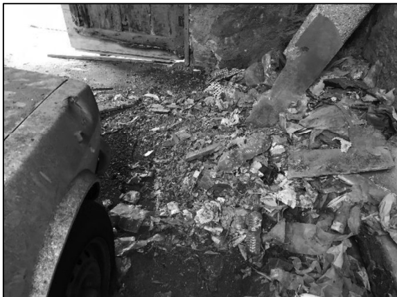
Pavimento con detriti vari
