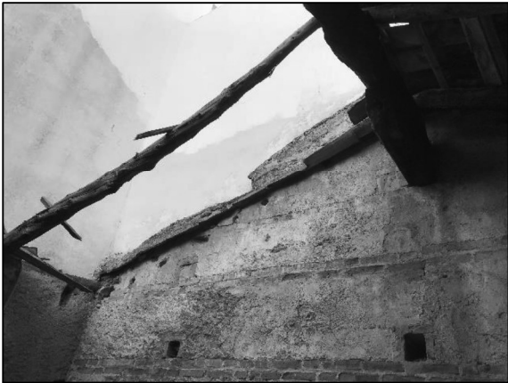
Parte del tetto crollata
