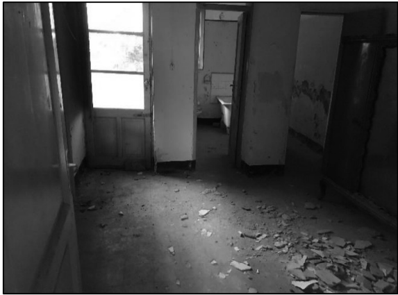
Stanza con evidenti distacchi intonaco
