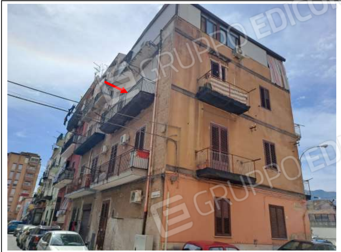
Foto n. 3 – Immobile sito in Palermo, Via Brancaccio n. 12, piano 2°. Prospetto su Via Antonio Grano
