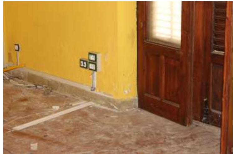
Particolare impianto elettrico Vano (2)
