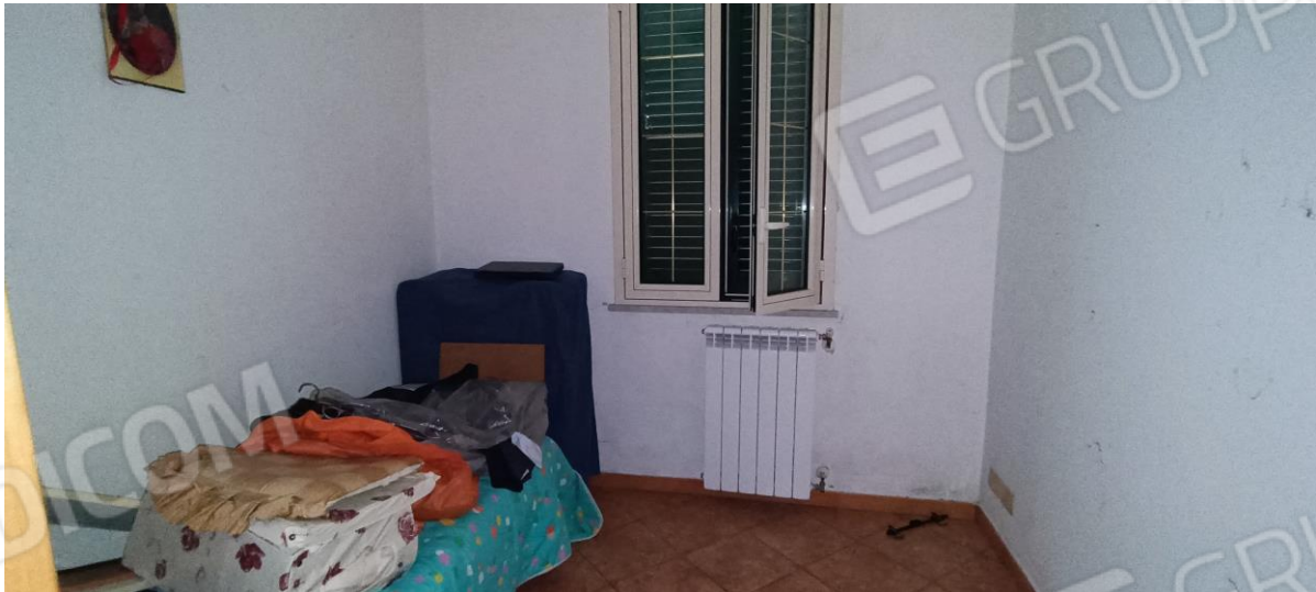
Foto n. 12 - Vani interni dell'unità immobiliare, infissi in alluminio e vetro, i vani sono dotati di piastre riscaldanti - fenomeni di umidità di risalita
