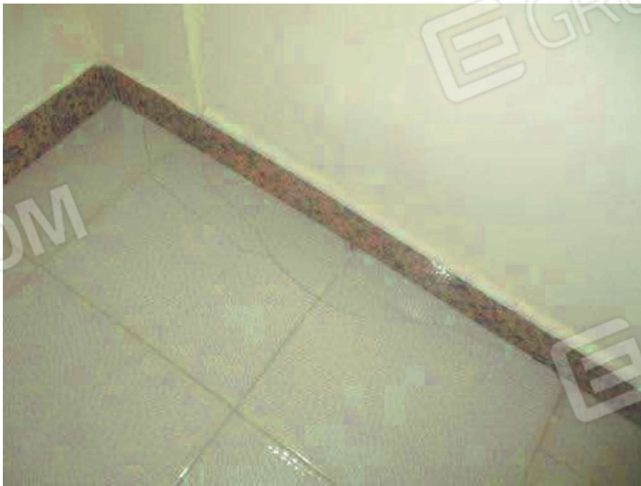
Foto 24 -vista della fessurazione a pavimento della prima stanza
