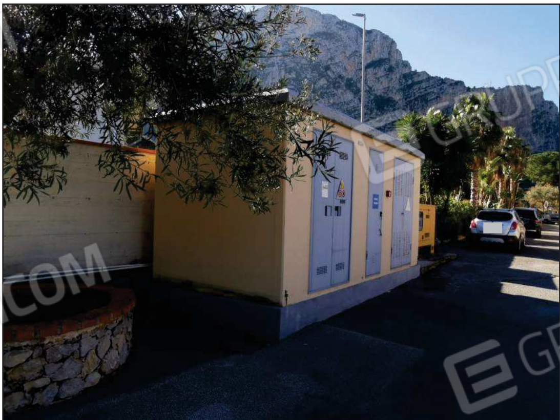
Cabina di trasformazione elettrica insistente sul sub. 4
