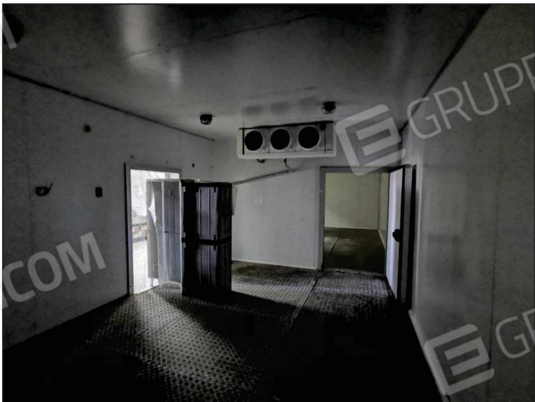
Cella frigorifera ubicata al primo piano (sub. 3)
