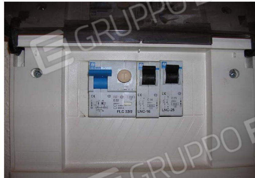
vista quadro elettrico
