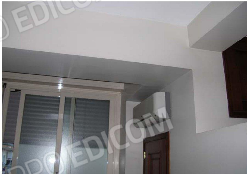
vista cucina/soggiorno (particolare zona muratura/infissi da ripristinare/rimuovere)
