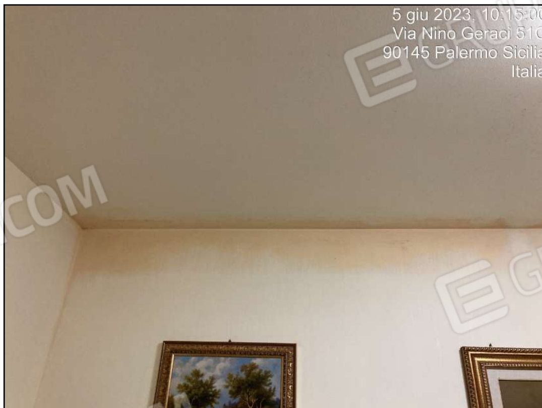
Foto n. 28 - Interni: segni di umidità da condensa nella camera da letto matrimoniale
