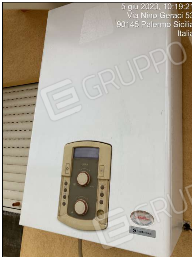
Foto n. 29 - Interni: caldaia sul balcone della camera da letto matrimoniale
