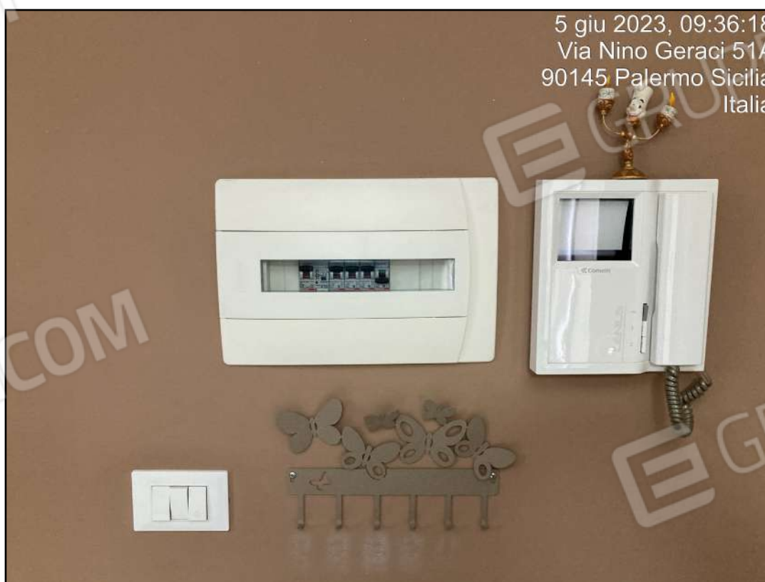
Foto n. 12 - Interni: quadro elettrico e videocitofono
