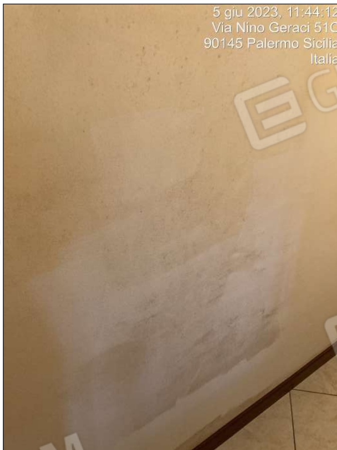
Foto n. 16 - Interni: segni di umidità di condensa lungo il corridoio in corrispondenza dei pilastri
