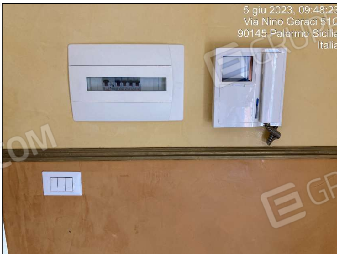
Foto n. 12 - Interni: dettaglio quadro elettrico e videocitofono
