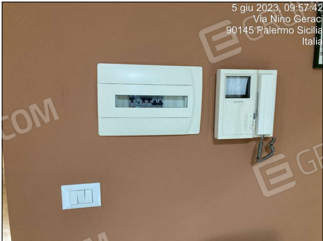
Foto n. 12 - Interni: dettaglio quadro elettrico e videocitofono
