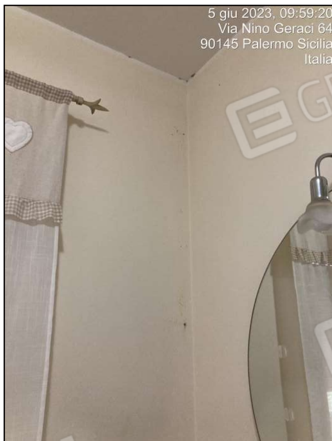
Foto n. 20 - Interni: w.c. con doccia - dettaglio condensa angolo parete
