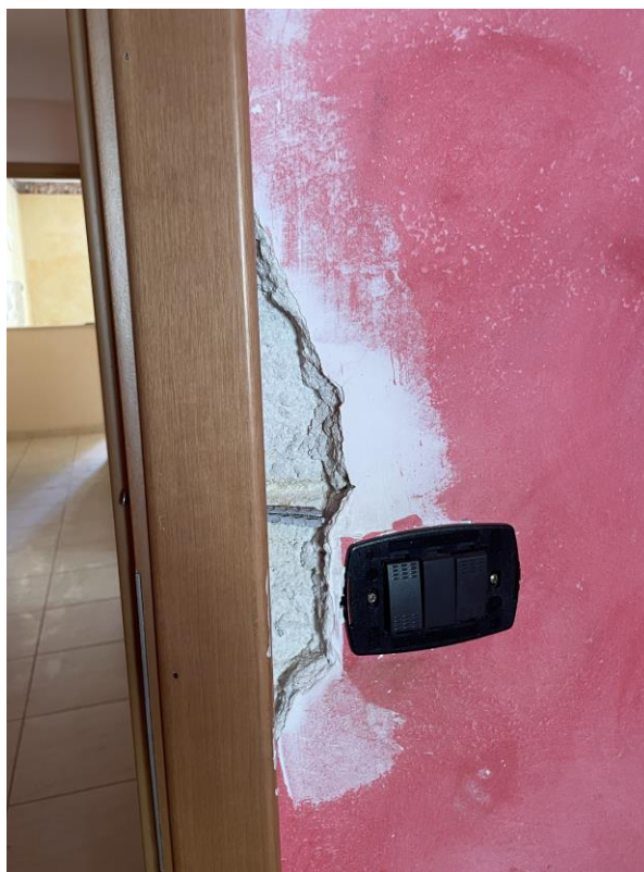
Foto 20 - Particolare della camera da letto. Si nota un distacco dell'intonaco in prossimità dell'interruttore
