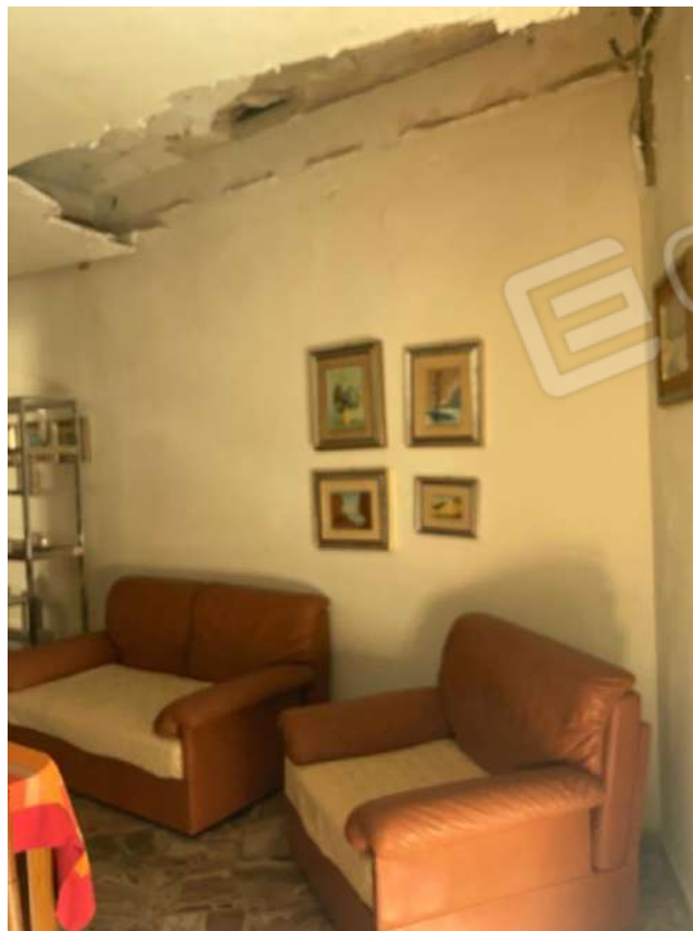
SALONE – PARTICOLARE SOLAIO SFONDELLATO
