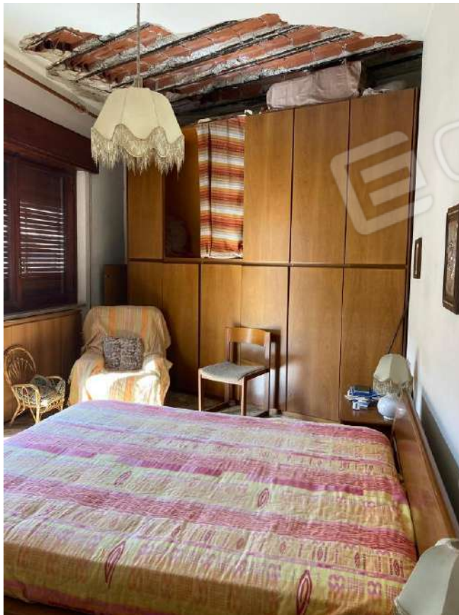
PARTICOLARE SOLAIO SFONDELLATO CAMERA LETTO 2
