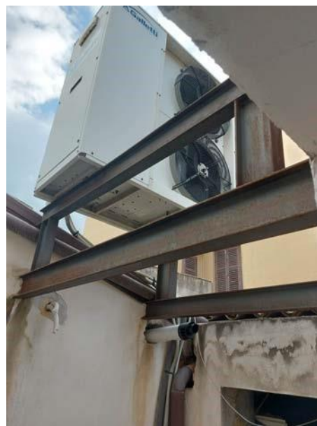
36. IMPIANTI SU POZZO LUCE
