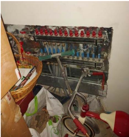
32. AMBIENTE 3 – COLLETTORE IMPIANTO RISCALDAMENTO A PAVIMENTO
