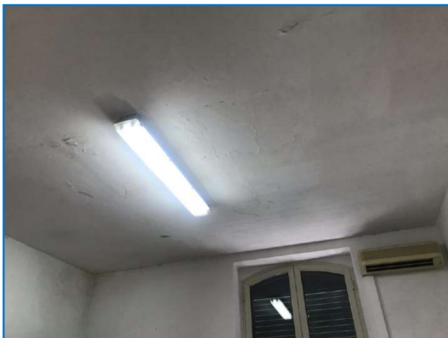
Intonaci ammalorati e mal ripristinati in un vano
