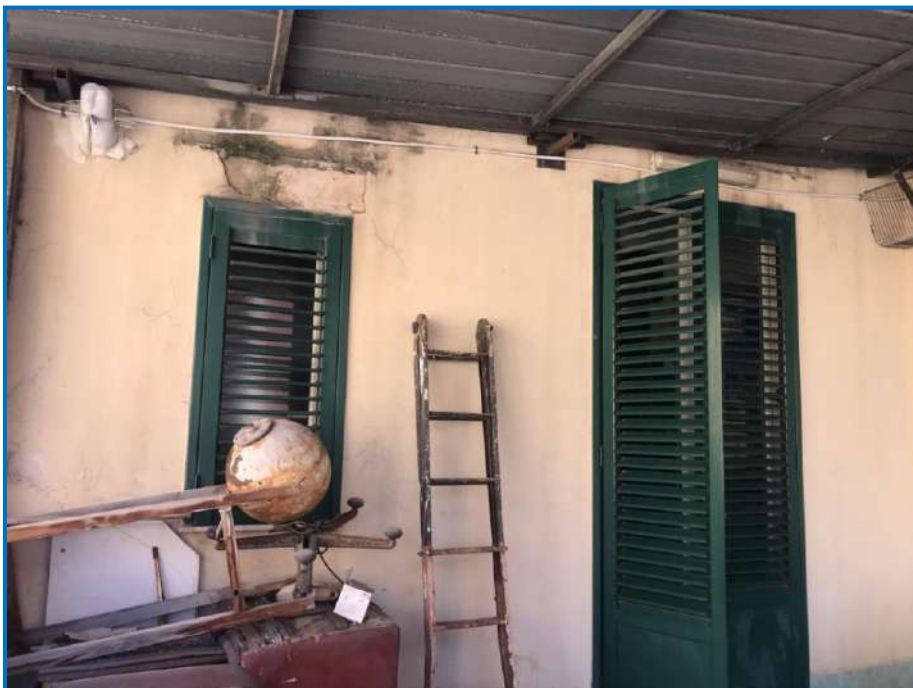
Intonaci esterni del prospetto sulla terrazza degradati
