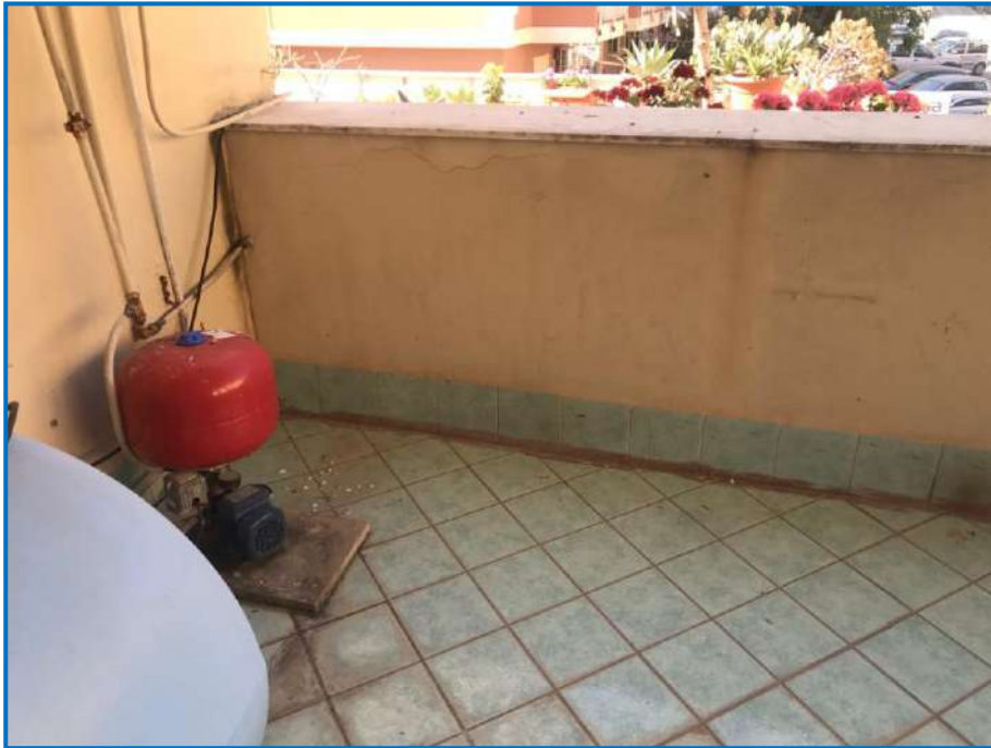
Lesioni negli intonaci del parapetto della terrazza
