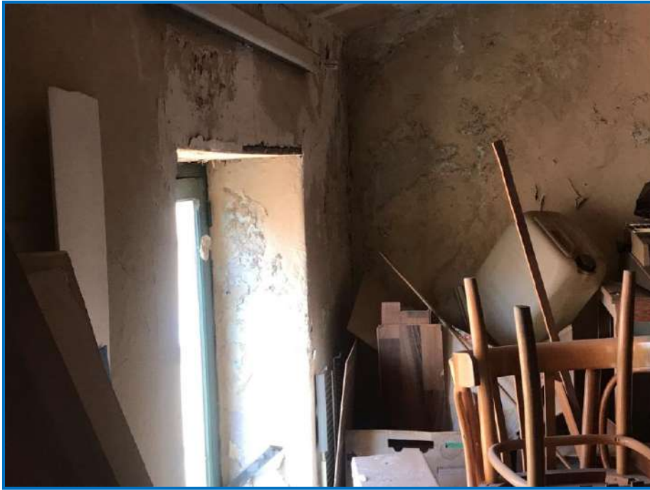
Intonaci ammalorati del vano sottotetto
