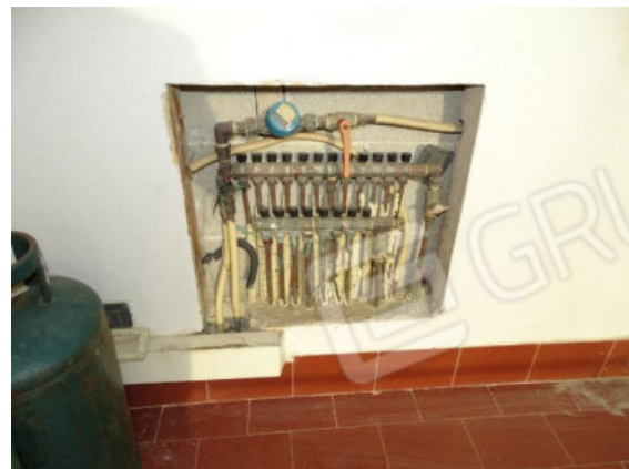
Impianto idrico sanitario del tipo a collettori, posto nel balcone sul prospetto principale.
