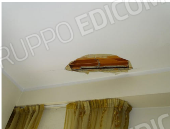
Cucina abitabile. Particolare del soffitto ammalorato
