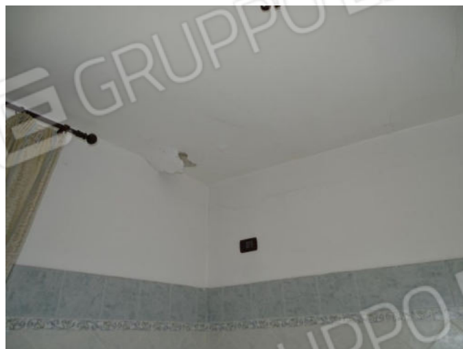
Soffitto del locale wc
