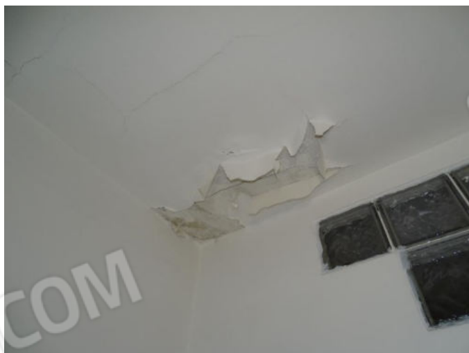
Soffitto del locale wc
