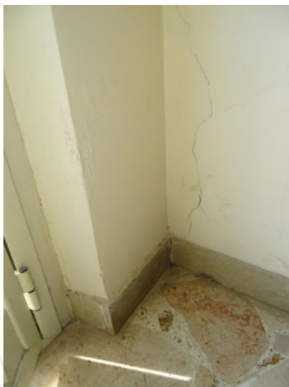
Soggiorno: particolare di una lesione su di un pilastro.
