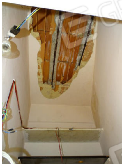
Soffitto ammalorato del ripostiglio
