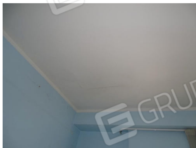
Particolare del soffitto ammalorato.
