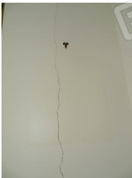
Soggiorno: particolare di una lesione su di un pilastro in corrispondenza dell'infisso
