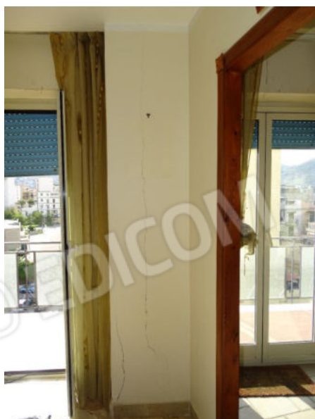
Soggiorno: particolare di una lesione su di un pilastro in corrispondenza dell'infisso
