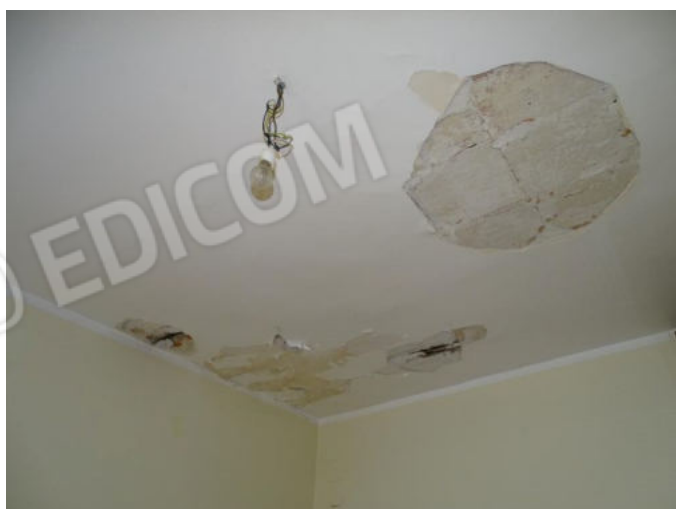
Camera da letto n.1: soffitto ammalorato
