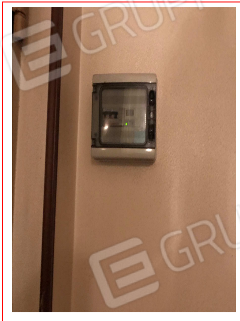
Foto n°31: Quadro elettrico ubicato nella sala (Vano 1).
