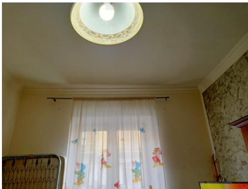
Vano al 1° piano
