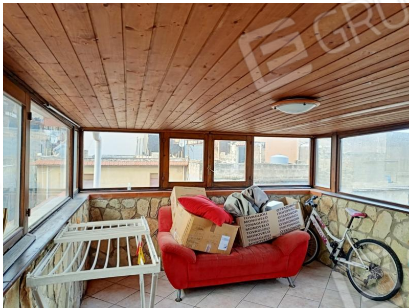
Foto n°17 – veranda abusiva sul terrazzo di copertura
