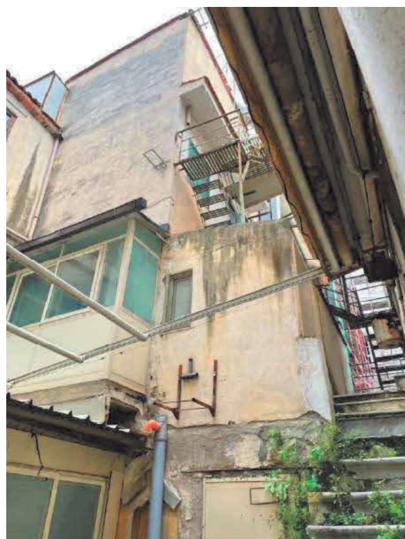
Sopraelevazione abusiva 2°-3° piano
