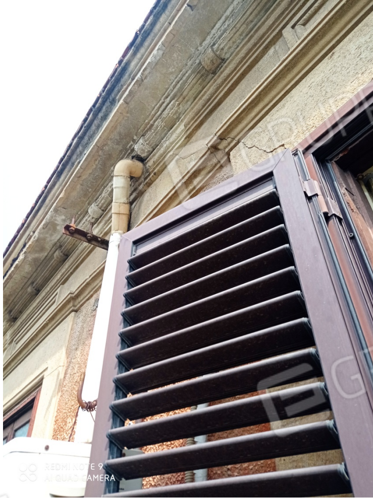
Foto 14. Particolare pluviale rotto
