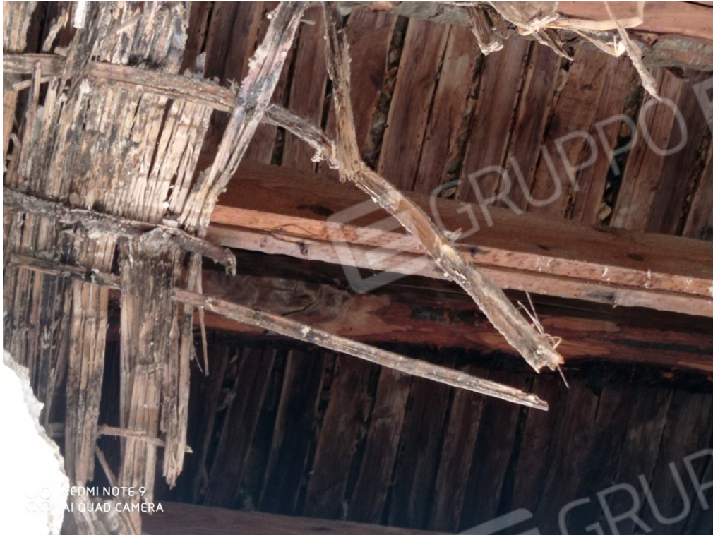
Foto 7. Danni al solaio ligneo, deterioramento delle travi e del tavolato
