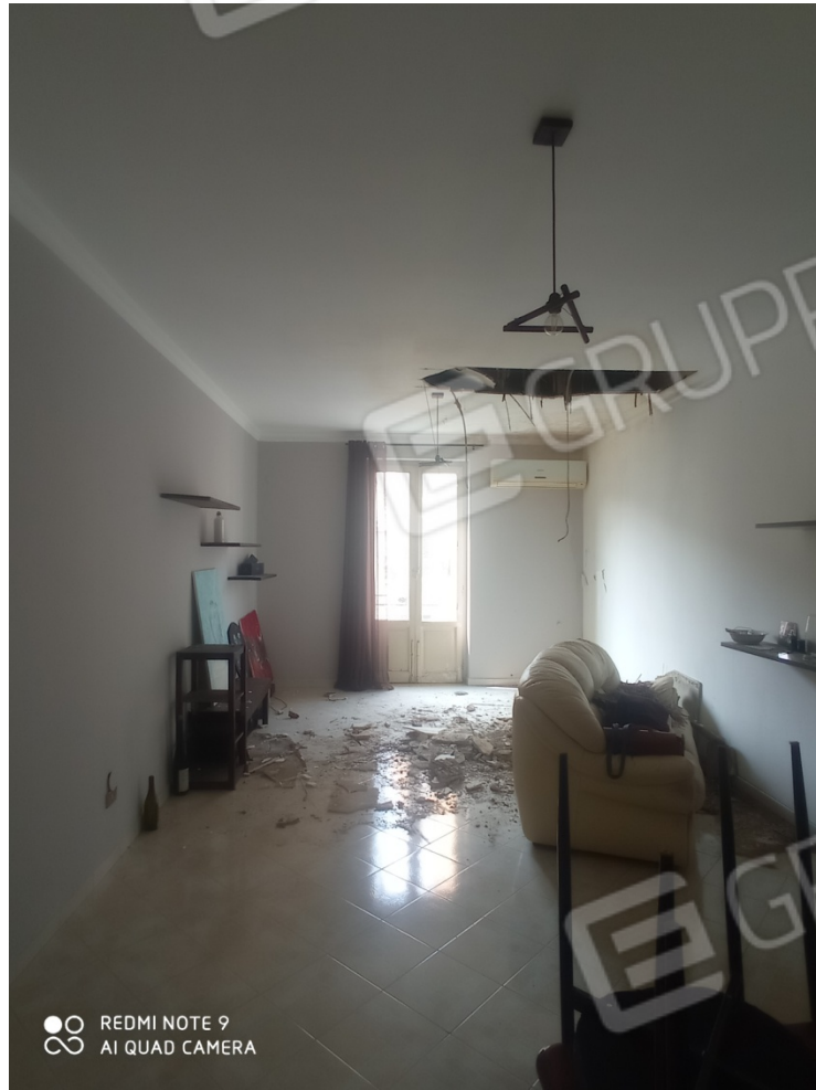
Foto 5. Veduta del salotto con crollo di porzione del solaio
