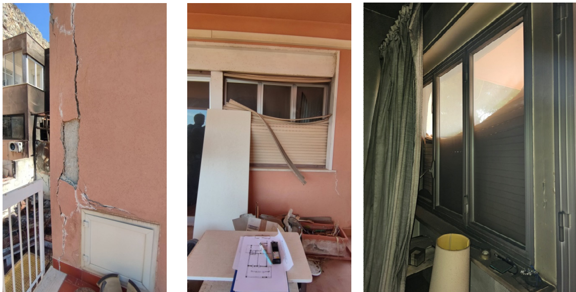
Fig. 55-56-57- danni all'intonaco, infissi
