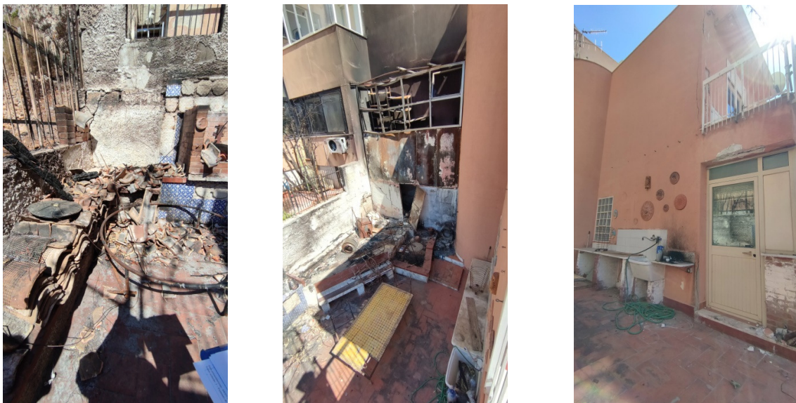
Fig.49-50-51 danni causati dall'incendio
