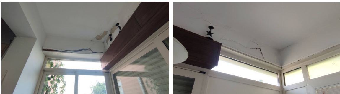
Fig.47-48 lesioni di intonaco al di sopra degli infissi della veranda
