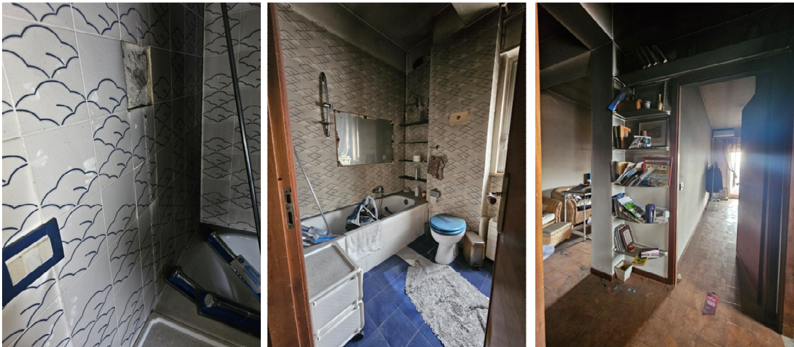
Fig. 60-61-62- danni nel bagno con il distacco delle piastrelle- danni diffusi nell'appartamento
