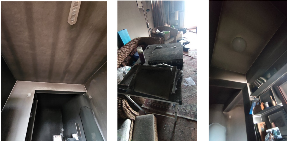
Fig. 63-64-65- danni diffusi nell'appartamento
