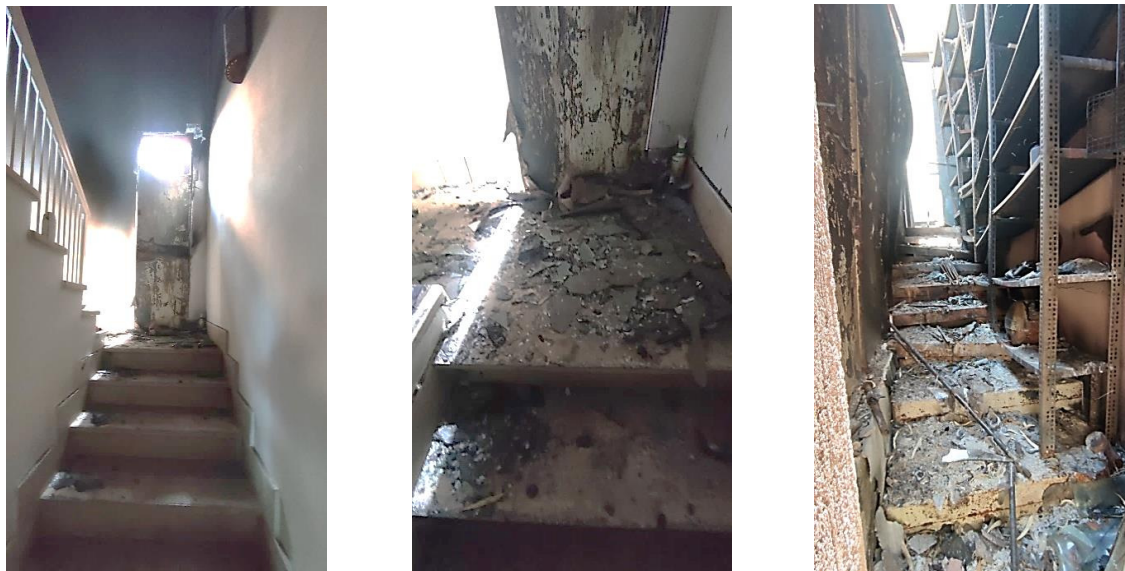
Fig.52-53-54 danni causati dall'incendio al vano scala e al corpo esterno
