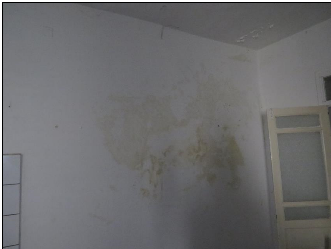
Macchie di umidità al primo piano
