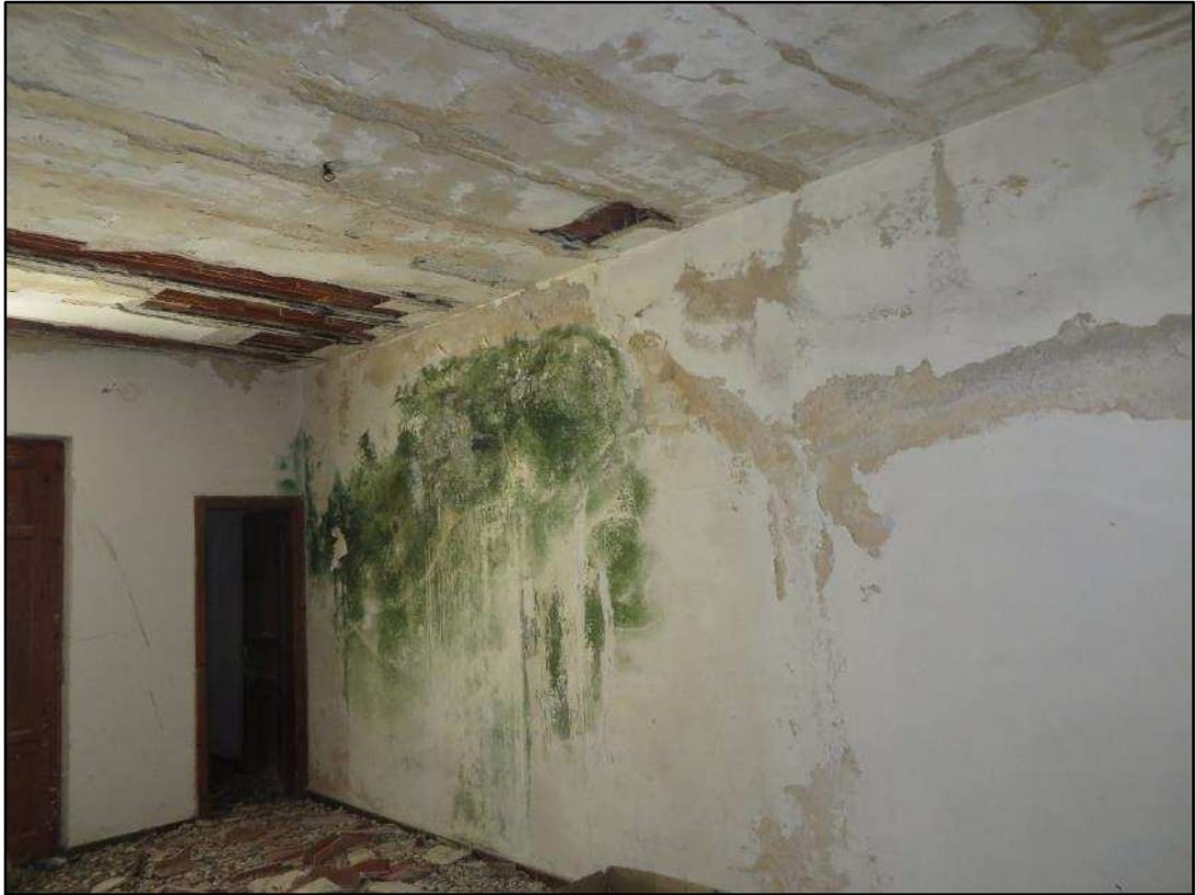
Ammaloramenti al terzo piano
