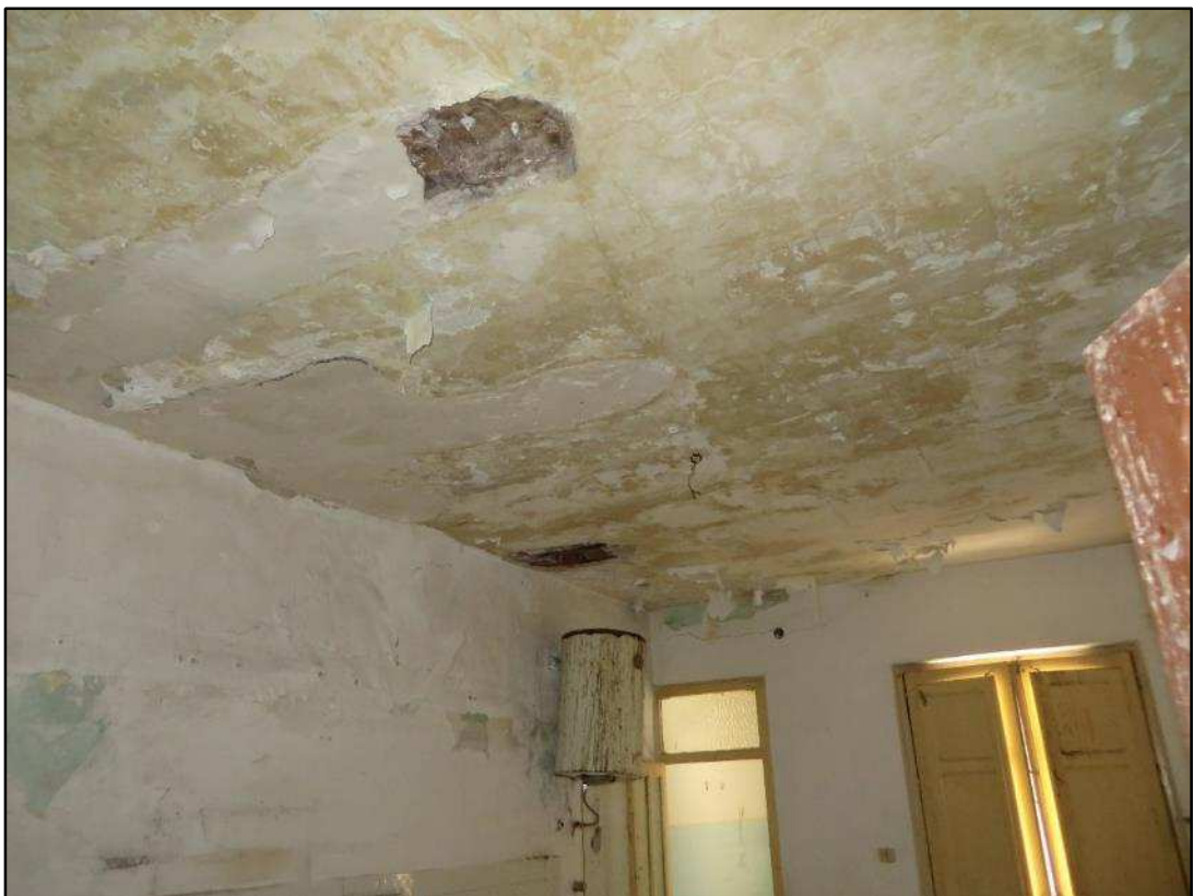
Ammaloramenti al terzo piano
