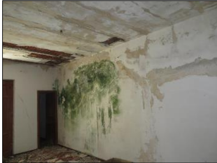
Ammaloramenti al terzo piano
