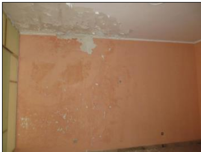
Ammaloramenti al secondo piano
