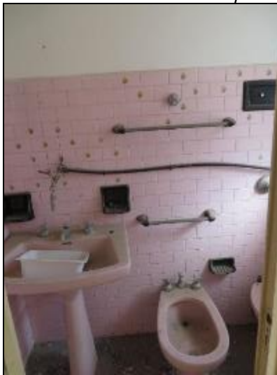
Servizio igienico del secondo piano
