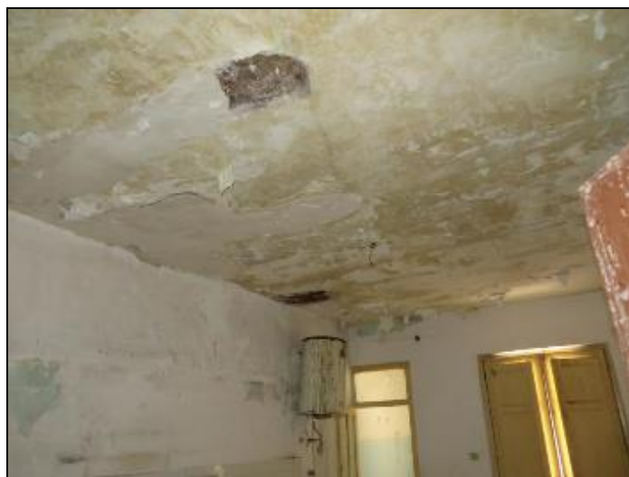
Ammaloramenti al terzo piano
