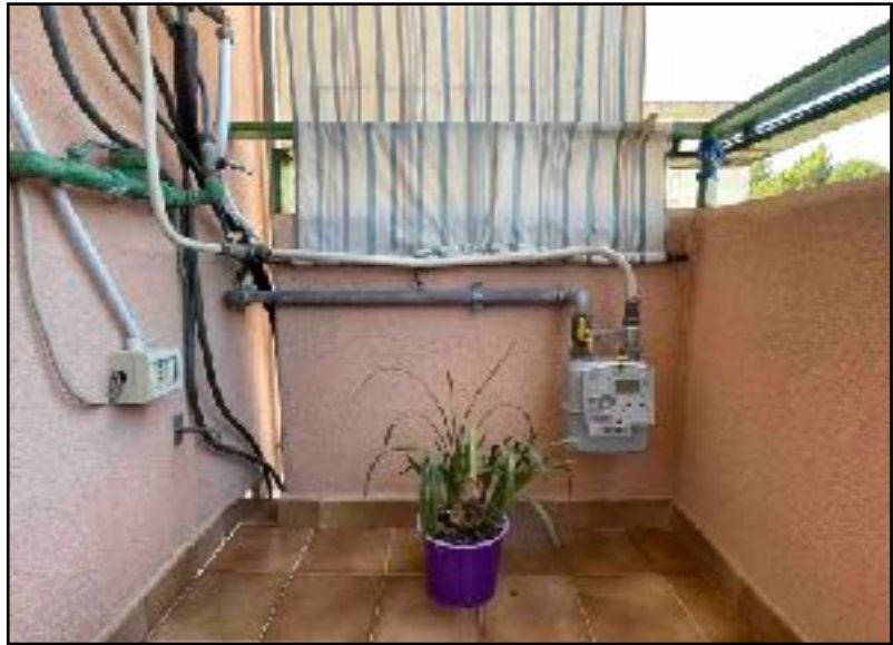
Fig.29 Impianto del gas
