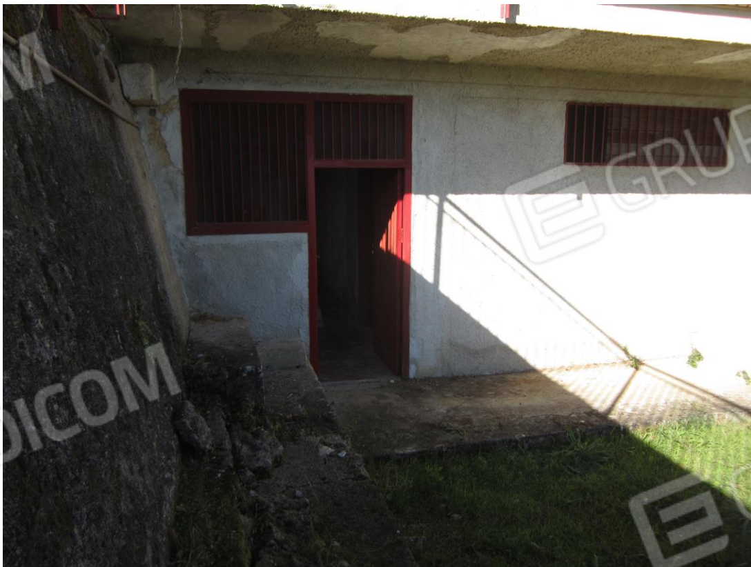
Foto 26: il portone metallico attraverso il quale si accede al vano del piano semicantinato che ospita la riserva idrica ed il gruppo autoclave
