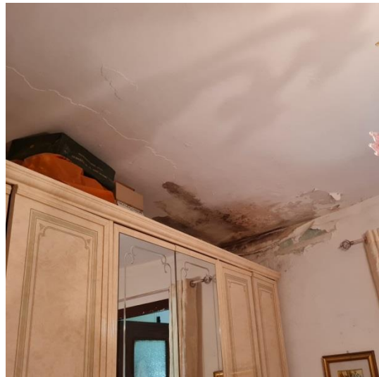
-danni da infiltrazione nel solaio.
