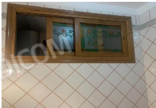
P2°: vano con caldaia
