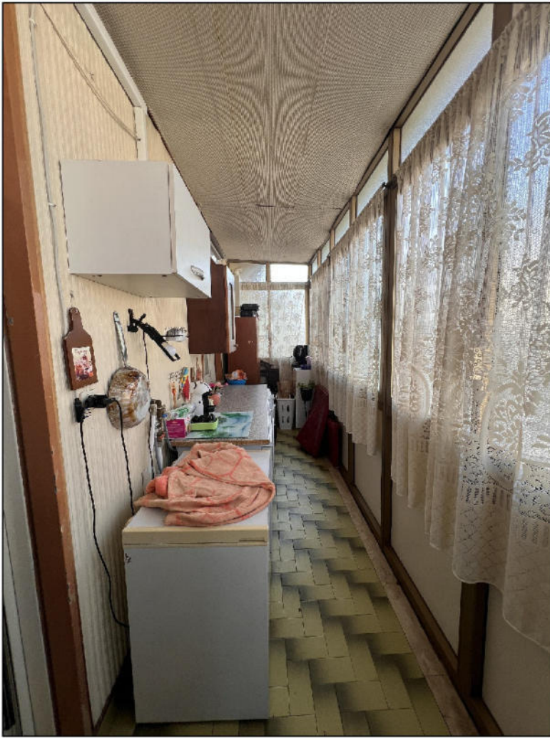
veranda chiusa con struttura precaria
