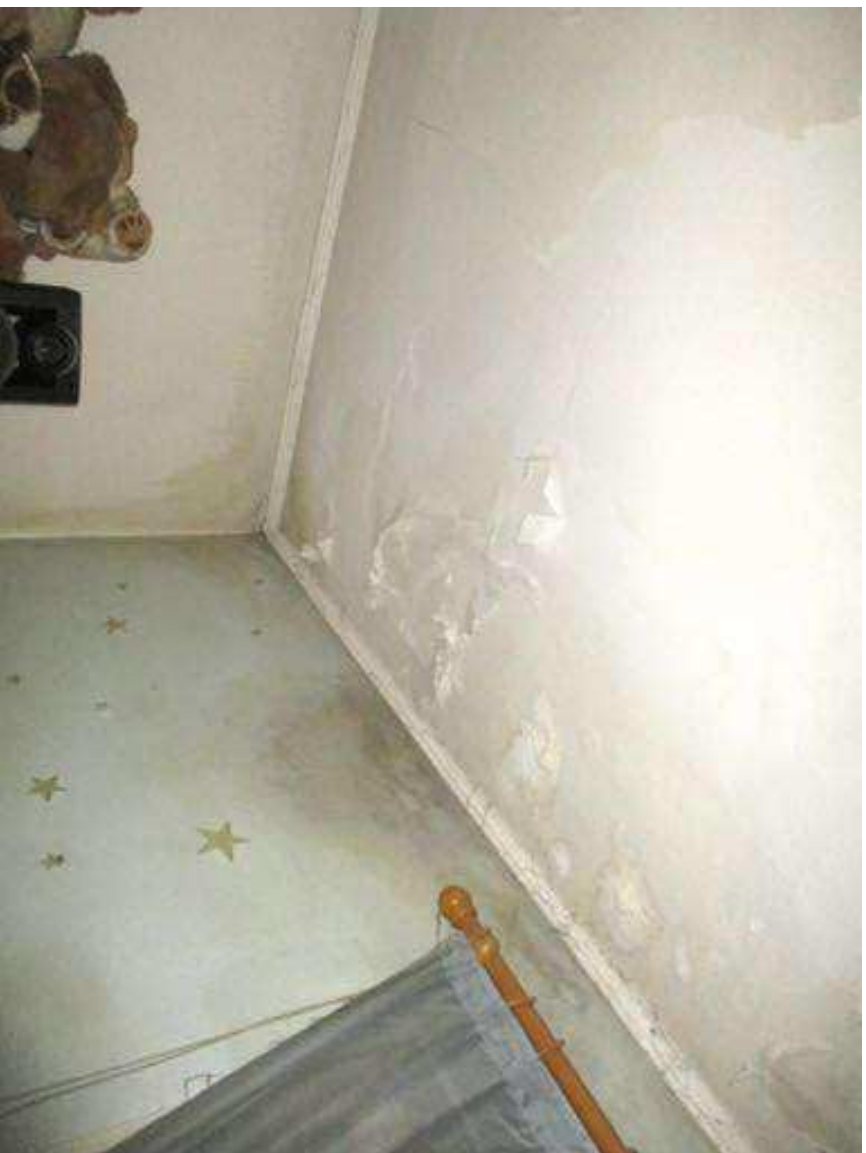
Foto 24 - particolare del soffitto di una camera dell'appartamento
