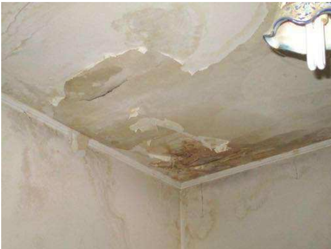
Foto 26- particolare del soffitto di una camera dell'appartamento
