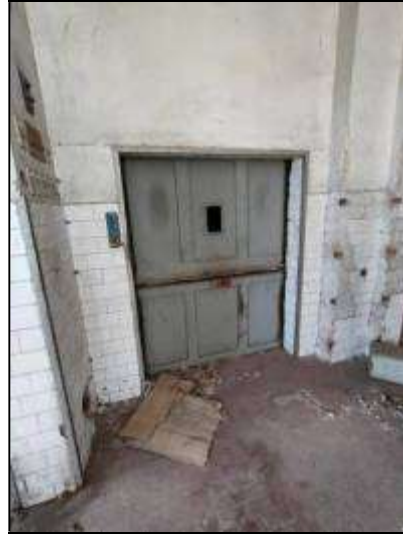
Montacarichi posto al piano terra
