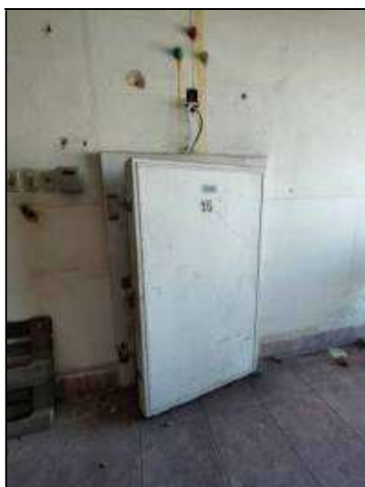
Porta di accesso ad una cella frigorifera del primo piano
