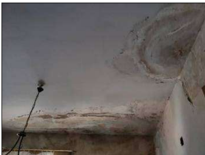
Infiltrazioni al primo piano del corpo B
