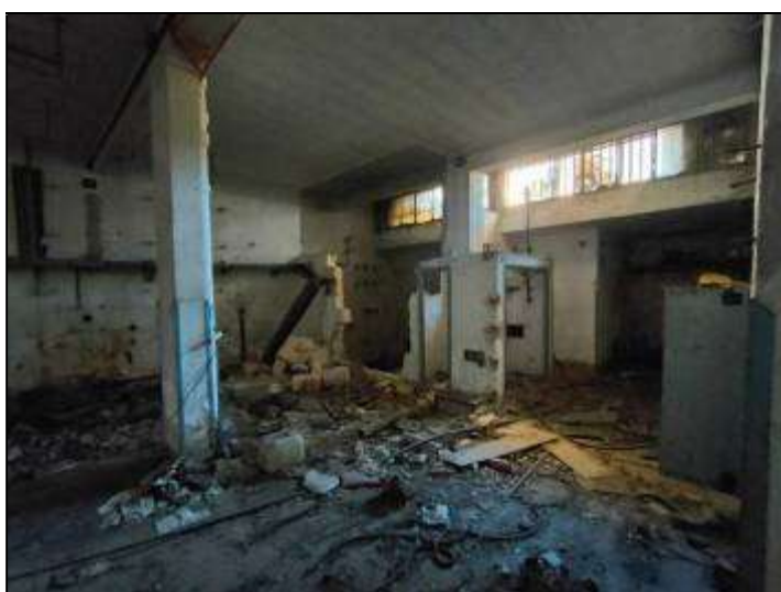
Locale tecnico al piano cantinato
