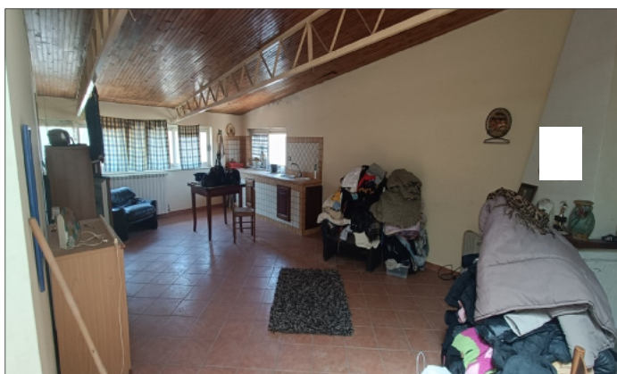
Vano aggiuntivo P3° (abusivo)
